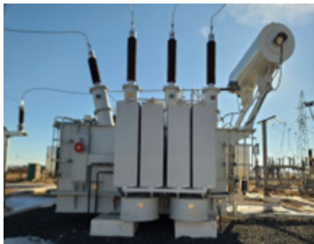
Өндөрхаан дэд станц
